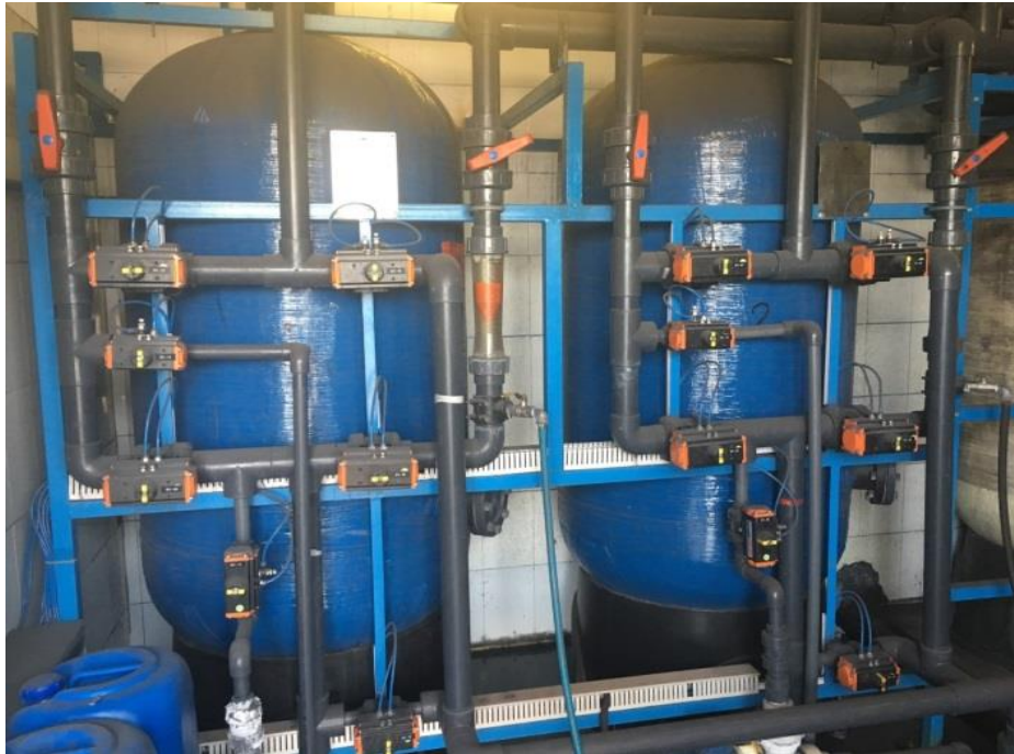
شکل ۸- سیستم تصفیه آب رزینی
