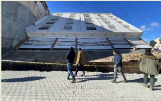
واژگونی ساختمان به علت کمبود ظرفیت باربری خاک و انهدام پی
