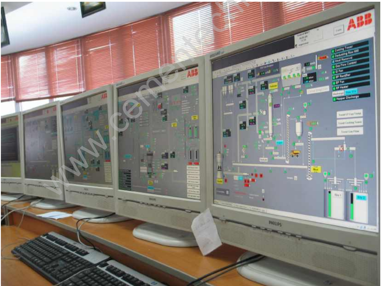
اتاق کنترل کارخانه های جدید
